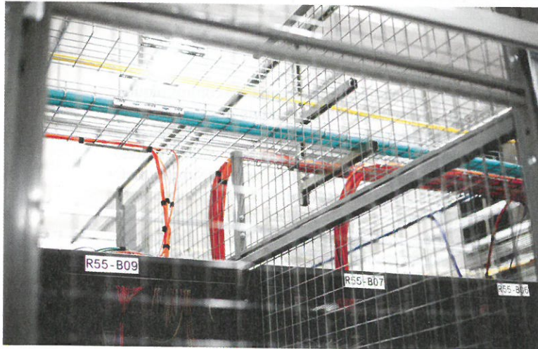
Dans la salle informatique, les serveurs sont protégés dans des espaces grillagés, accessibles par clé et par reconnaissance biométrique.
