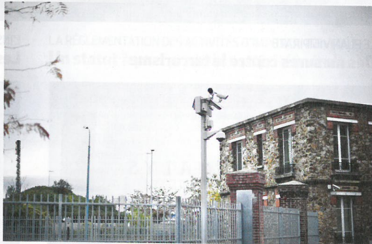
Toute tentative sauvage de pénétration dans le site est repérée par les détecteurs de mouvement. Et déclenche une alarme et l'activation des caméras.
